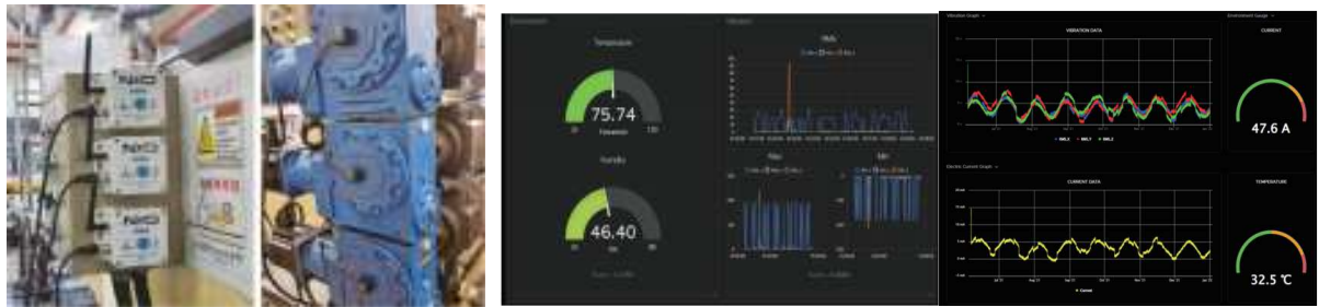
[진동센서 설치 모습]
